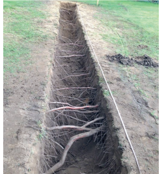
Freigelegte Wurzeln nach Saugbaggereinsatz
